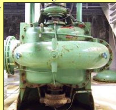
Intagspumpen före uppgradering.
