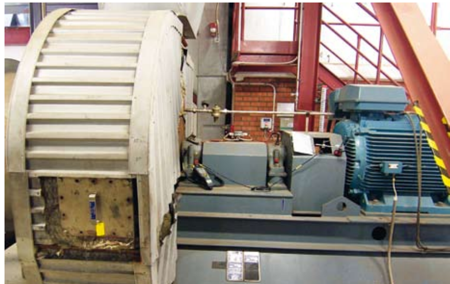
Den här rökgasfläkten har haft problem med frätskador, mekanisk nötning och obalans på grund av föroreningar som fastnat på fläktbladen. Genom att belägga fläkthjulet med komposit kunde problemen lösas.
