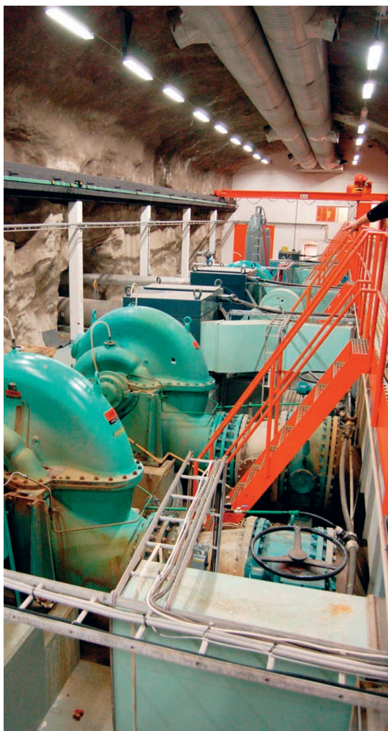
I berggrummet 54 meter under Himmerfjärdsverket finns en pumpstation med sex stora pumpar.
