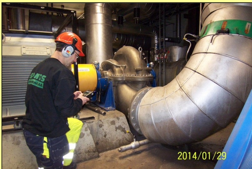
Tillståndskontroll på en fjärrvärmepump hos Norrenergi i Solna.
