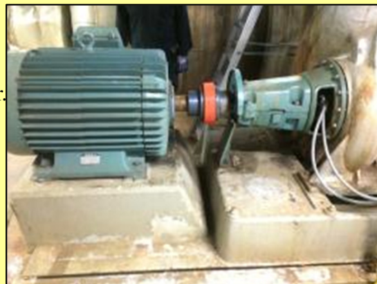
Bilden visar panncirkulationspump med motor samt det slitna fundamentet före uppgraderingen.
