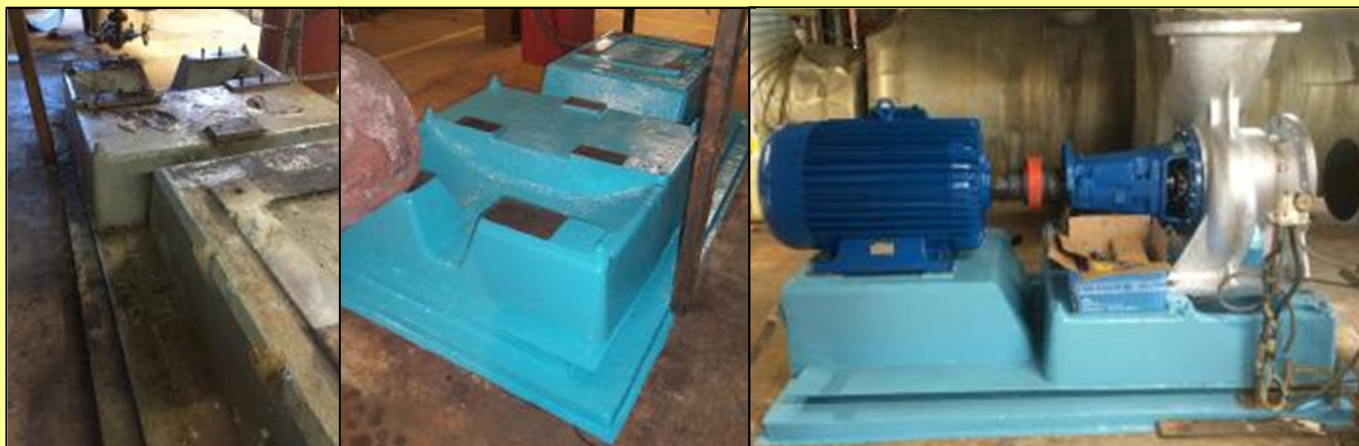
Till vänster det slitna fundamentet och i mitten det uppgraderade fundamentet med Chestertons komposit. Längst till höger syns den uppgraderade pumputrustningen inklusive det åtgärdade fundamentet.
