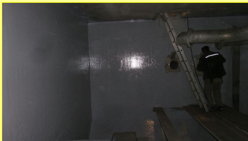
Bild från kompositbelagd betongsump.
