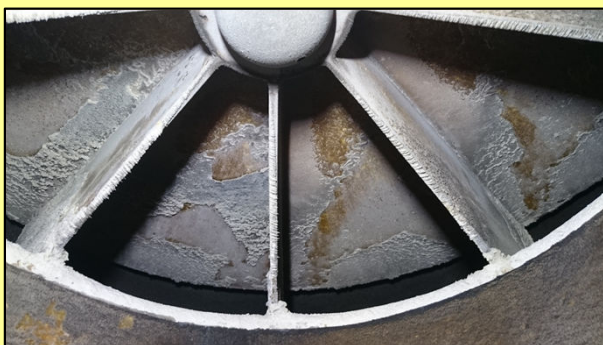
Vid rengöring avläsnades avlagringar från fläkthjulet.
