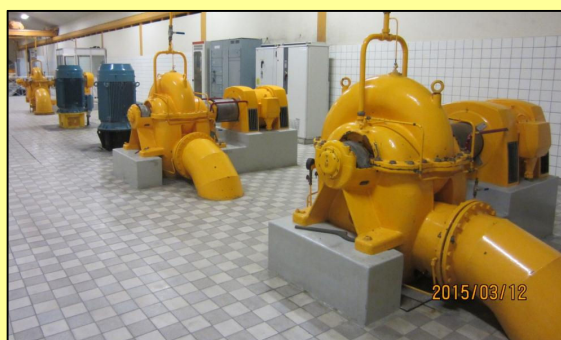
Foto från pumphuset över de fem råvattenpumparna som är av olika modeller, tre torrumpställda och två dränkbara som också är varvtalsstyrda.
