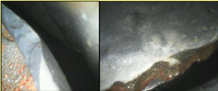
Bilder på pumphjulsskador fotograferade med fiberoptik.
