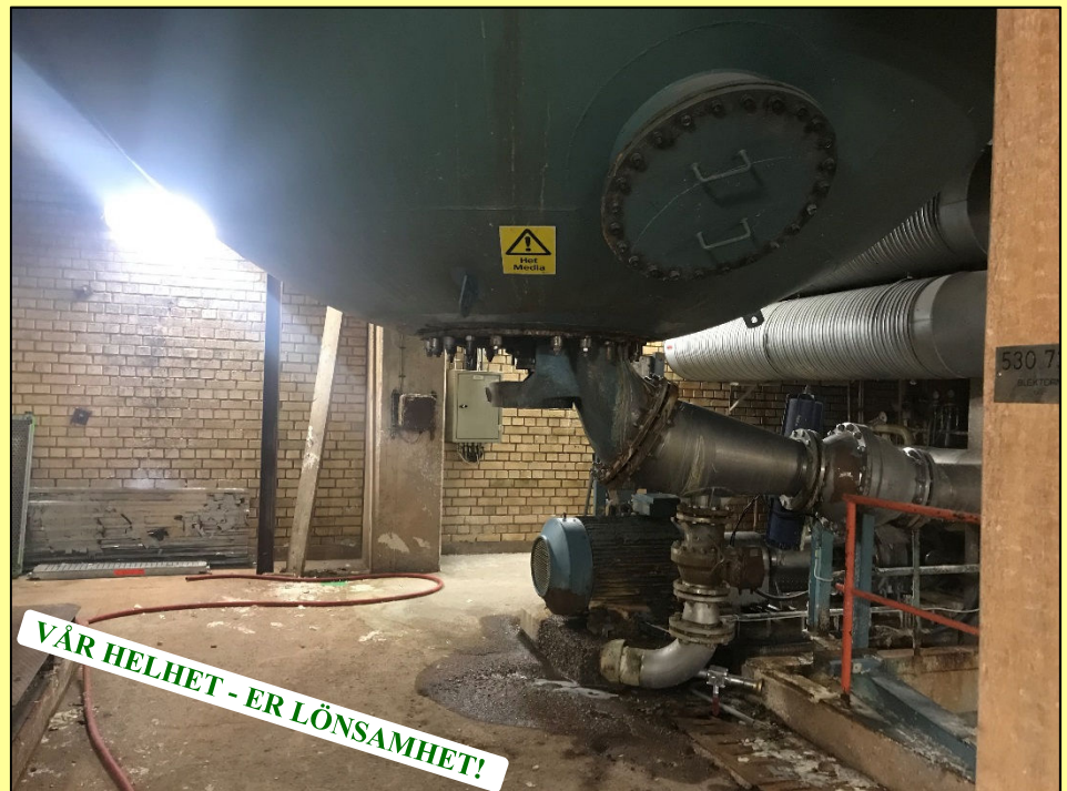
Undersidan på massatornet där läckage hos flänsen till bottenavtappningen tätades med Chestertons packning 860 MPG.
